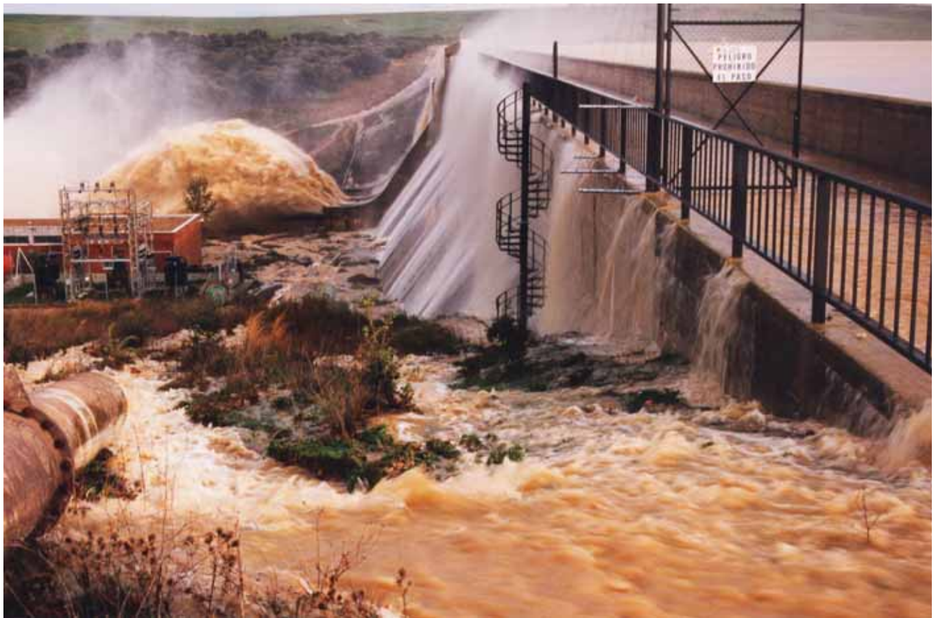
Fig. 5. Hemos de revisar los parámetros que condicionan las máximas avenidas (sin olvidar la gestión de las actividades antrópicas en cuencas y cauces) para evitar estos sucesos.
